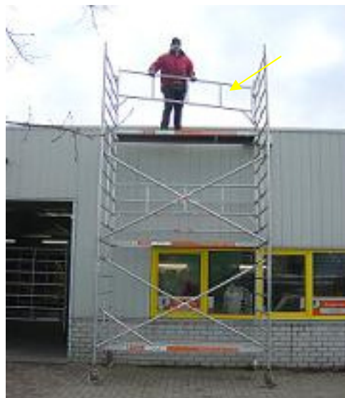
18. Plaats een dubbele leuning zie gele pijl (aan de rugzijde van de gebruiker)
