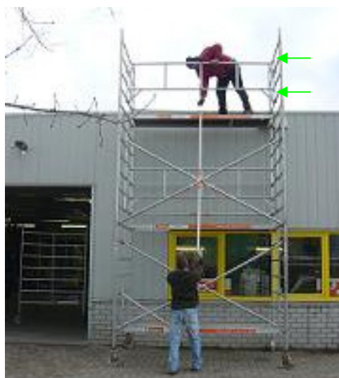
19. Plaats 2 maal horizontale steigerbuis aan de werzijde van de gebruiker op de 2 e en 4 e spot boven de loopplank (zie groene pijl)
