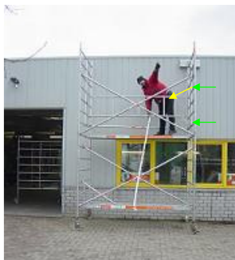
12. Plaats een dubbele leuning zie gele pijl (aan de rugzijde van de gebruiker) Plaats 2 maal horizontale steigerbuis aan de werkzijde van de gebruiker op de 2 e en 4 e spot boven de loopplank (zie groene pijl)
